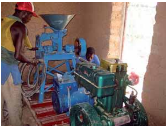
Energy Platform mit Pflanzenölgenerator und Mühle (Quelle: Mali Folkecenter)
