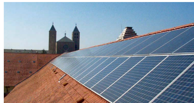
Die Photovoltaik-Anlage des Klosters
